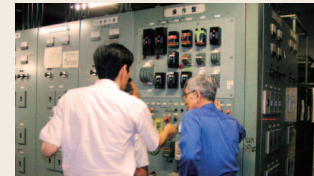
(財)省エネルギーセンターより省エネルギー診断を受審し、さらに省エネルギーに努めています。
